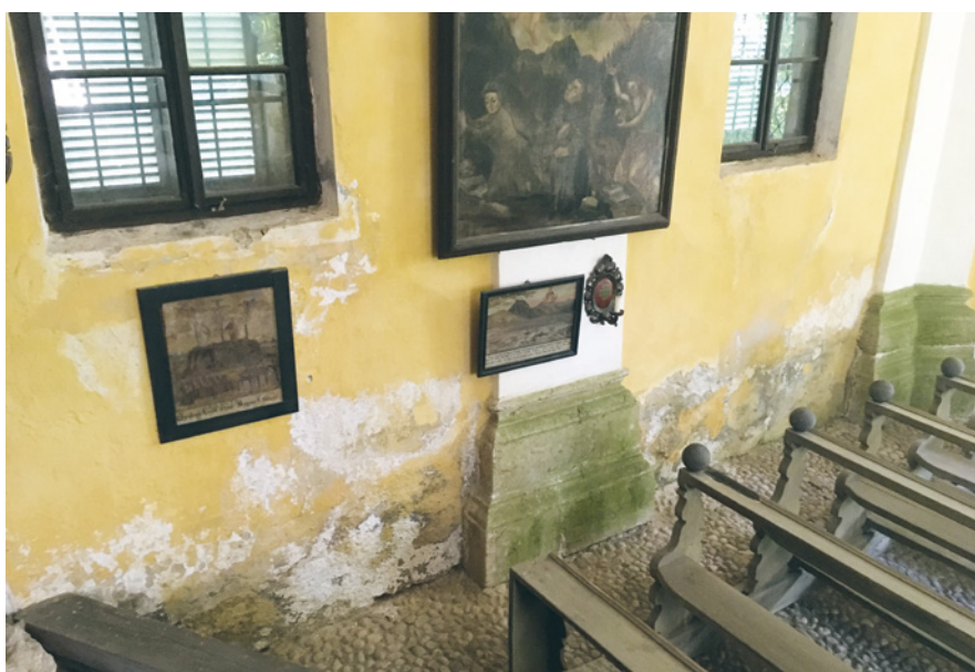
Eine Sanierung von Dach und Mauerwerk steht bevor und stellt die Pfarre vor eine große Herausforderung.
